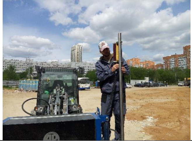
2-й шаг. Монтаж ресиверов (лазерных приемников) TOPCON на мачты из нержавеющей стали.
